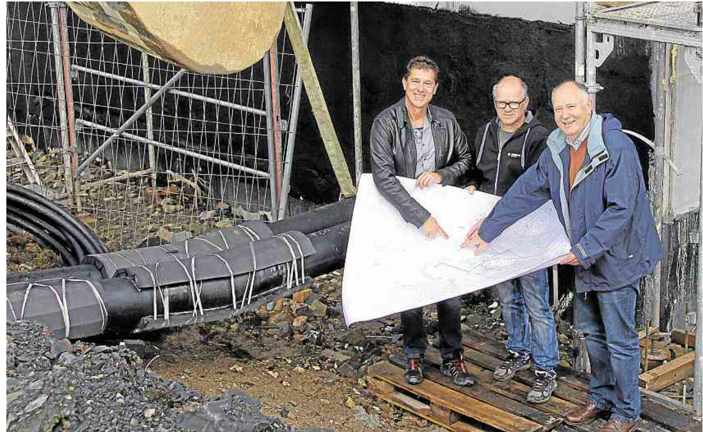
EDG-Geschäftsführer Reimond Spengler (von links), Holger Behnke (Tiefbau Behnke) und Bürgermeister Bernhard Alscher bei der Einbindung des letzten Teils des Leitungsnetzes an der Heizzentrale in der Brückener Straße
